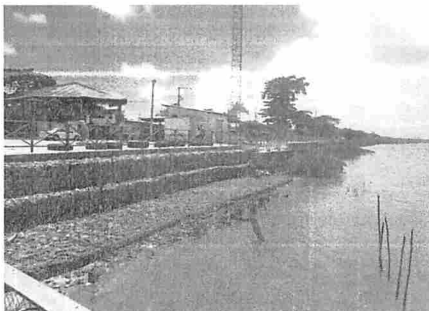
Figura 002 – Gabiões em granito e estrutura de concreto armado sob centro de atendimento ao turista
